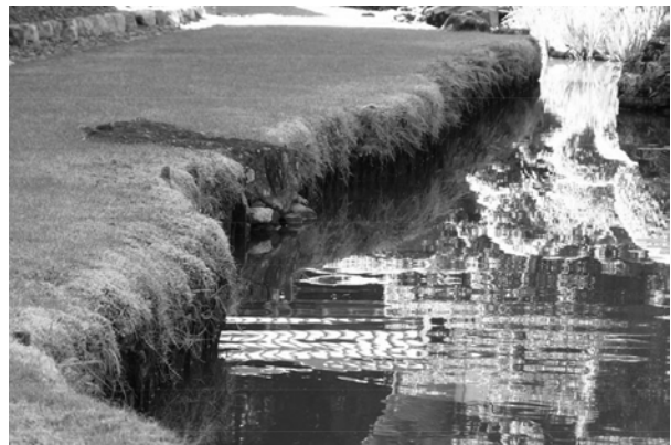
修理前 乱杭護岸
