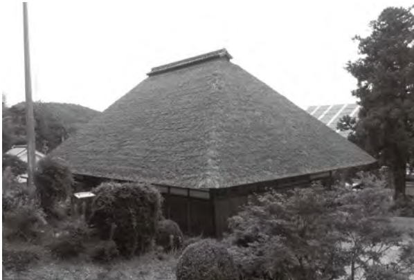
施工前 屋根表層に苔、茅の波打ちが見られる
