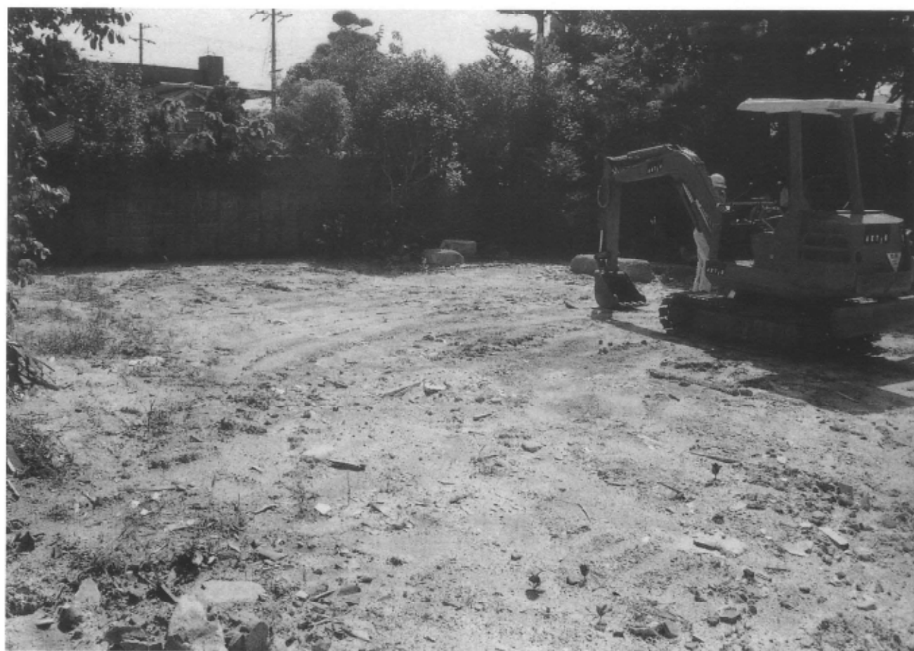
震災により住宅が全壊した調査地東側の現状（北西から）
