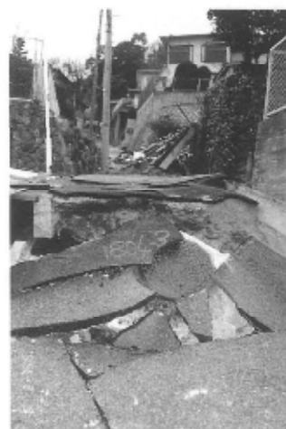
第19図 芦屋市三条町付近の道路上の地震れ (1995年2月9日撮影)
