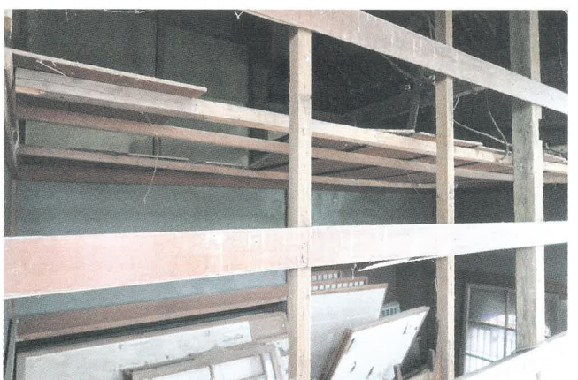
図 51 天井切断痕（詳細）
