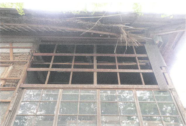
図 50 南面の天井切断痕
