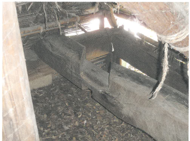
図39 北東隅の隅木痕跡
