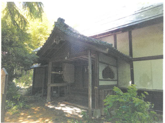
図58 玄関（応急修繕工事前）
