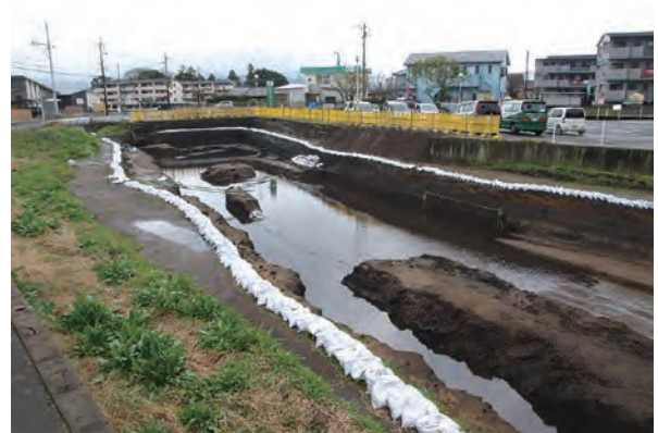
調査区水没状況
