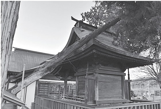
松尾神社本殿 倒木状況
