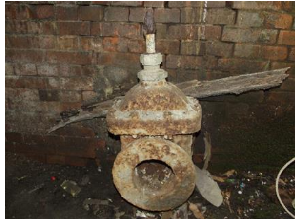
西側(駅方向)給水バルブ正面
