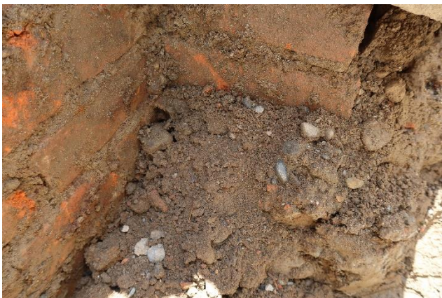
外壁接地部の砂混じりの土
