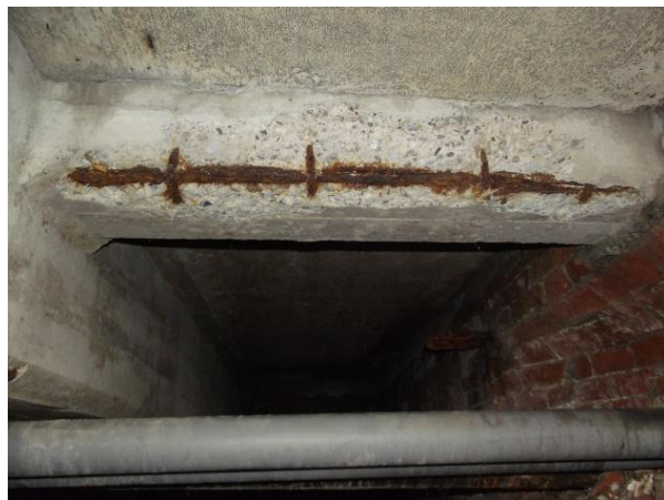
コンクリート構造物 劣化状況
