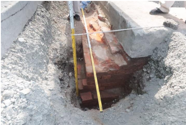
深さ約 1m コンクリート厚さ 300mm コーナーレンガ1個幅半分外へ出る
