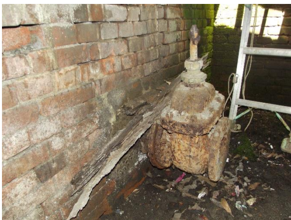
西側(駅方向)給水バルブ 横方向
