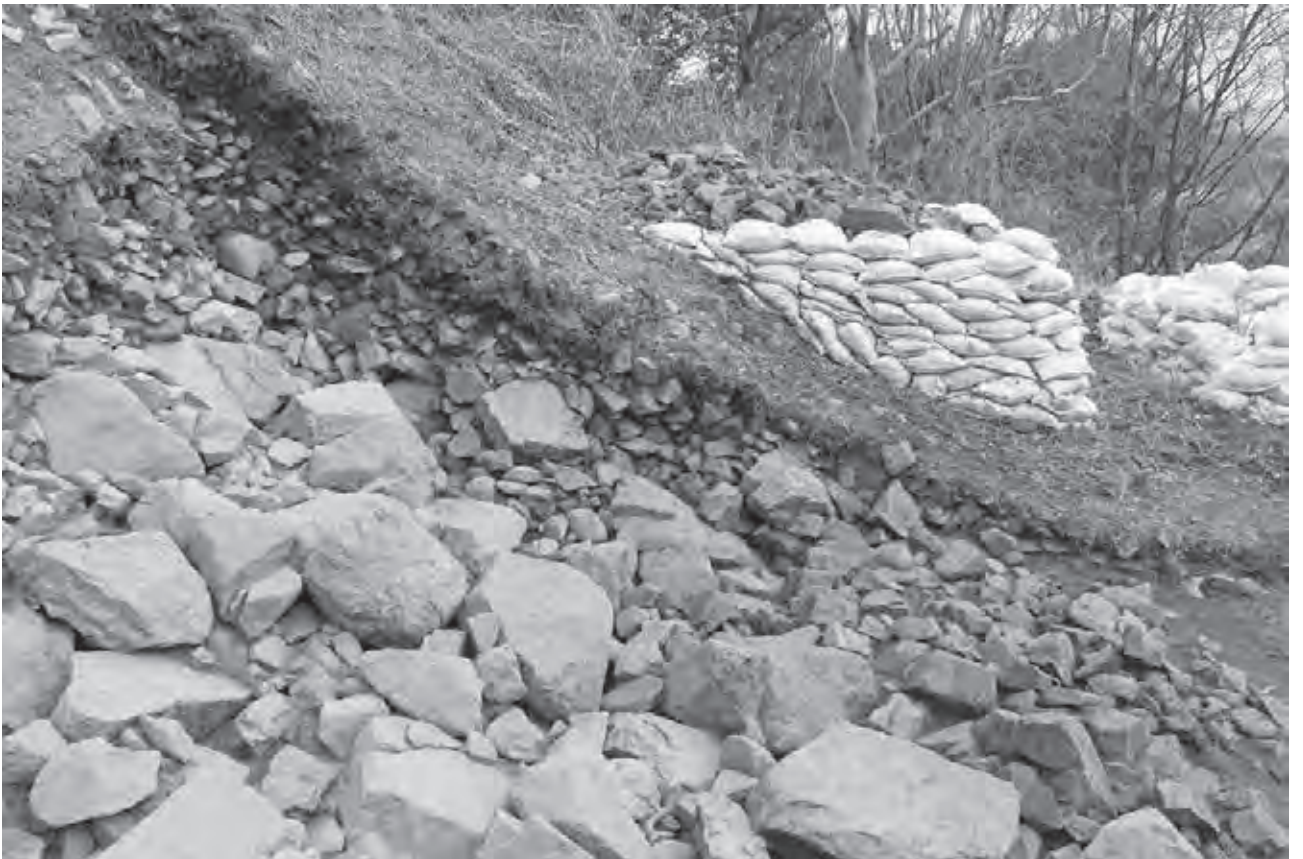
石垣 SW020101 崩落石堆積状況
