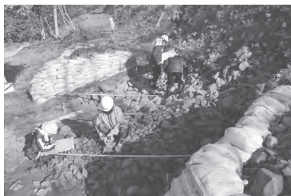
写真4 上段部 崩落石垣実測作業 平成26年1月29日撮影
