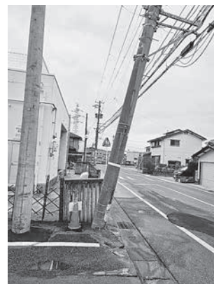
第28図 液状化で沈んだ電柱 (能登半島地震 新潟市西区)
