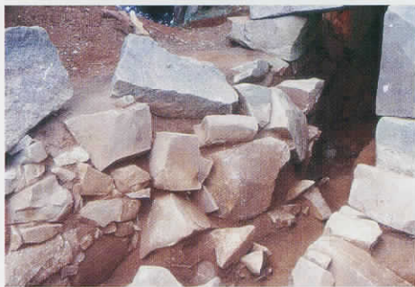
羨道西側壁崩壊部
