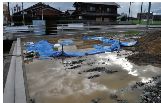
写真1-3 2区水没状況（西から）
