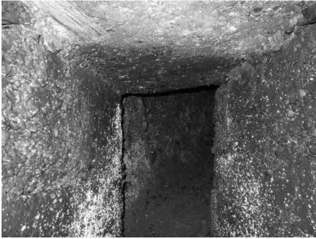
写真7 図2-⑦付近 狭いコンクリート通路 2019.6.18 撮影
