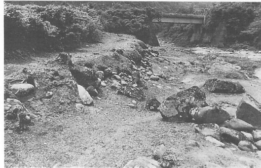
馬留橋付近の風化部分〈南西方向〉
