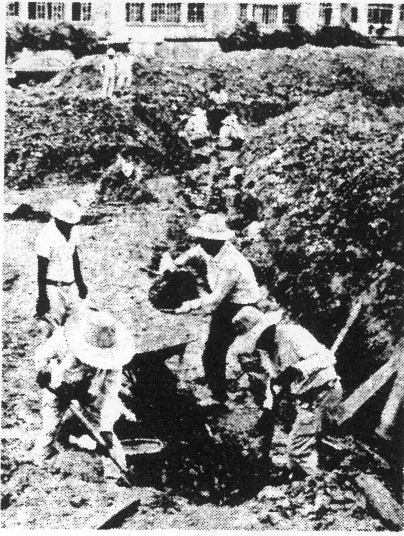
「御細工所の近くから発掘された石積みの側溝」城西小の造成工事現場
