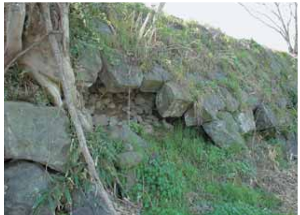
田口の刎 破損部分 石積下の裏込め石が見える
