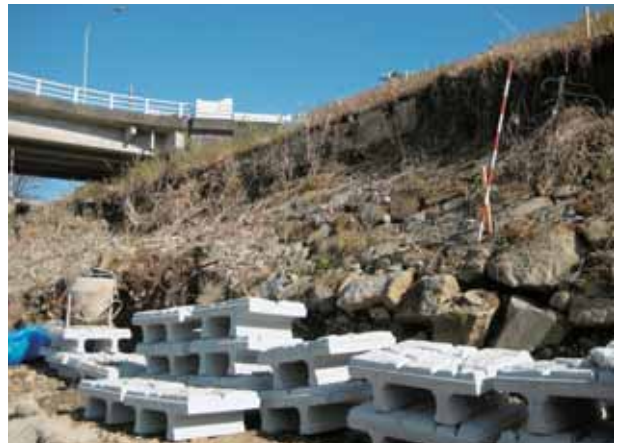
安津橋根元(右岸) 表出した石積
