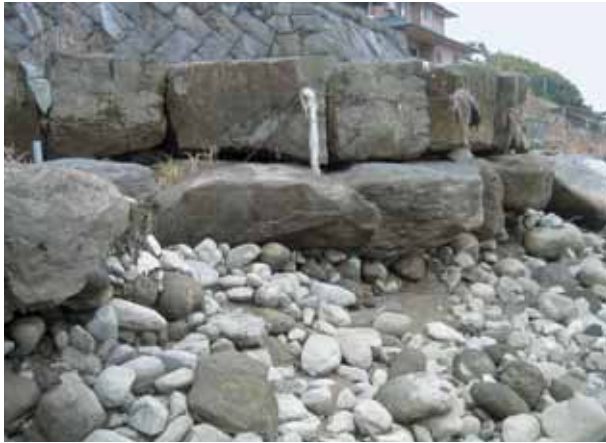
平成19年7月の被災により剥がれた石敷(左岸)①
