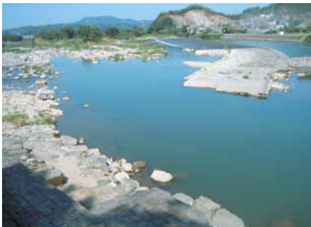
平成19年7月 被災後の鶺ノ瀬堰 洪水後の鶺ノ瀬堰 コンクリート部分・石畳部分ともに大きく壊された
