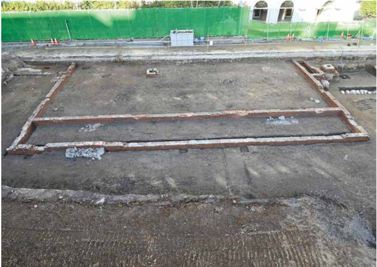
写真1 府立第一高等女学校の講堂と考えられる建物基礎 (35号遺構)
