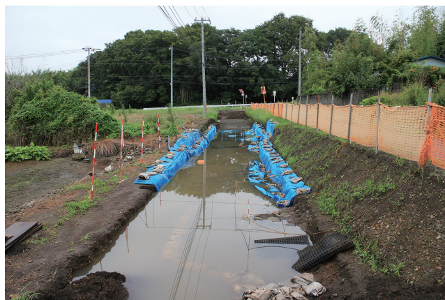
9月3日調査区冠水の状況 西から
