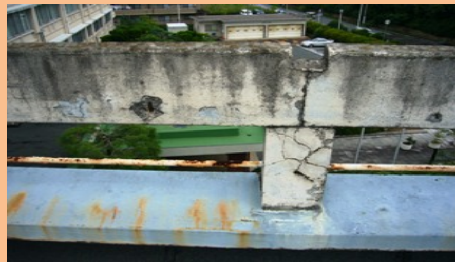
③劣化状況一例写真(屋上手すり)
