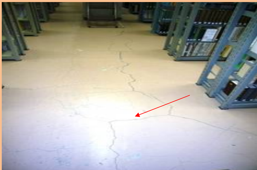
①建物内部 床クラック
