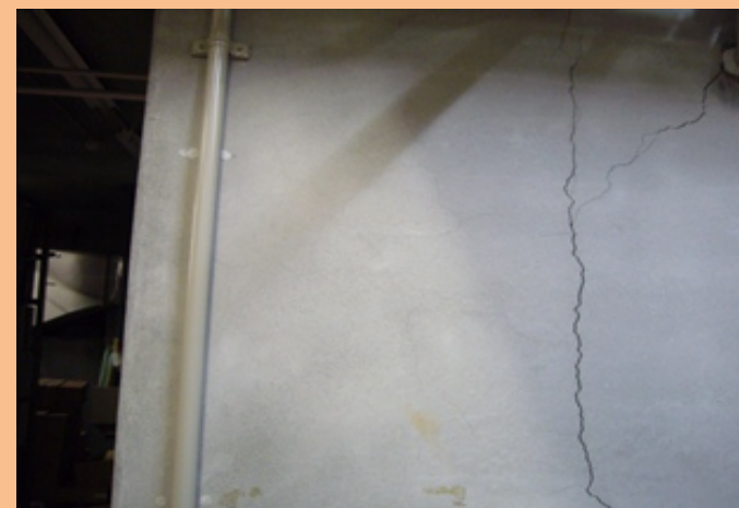
③建物内部 壁クラック
