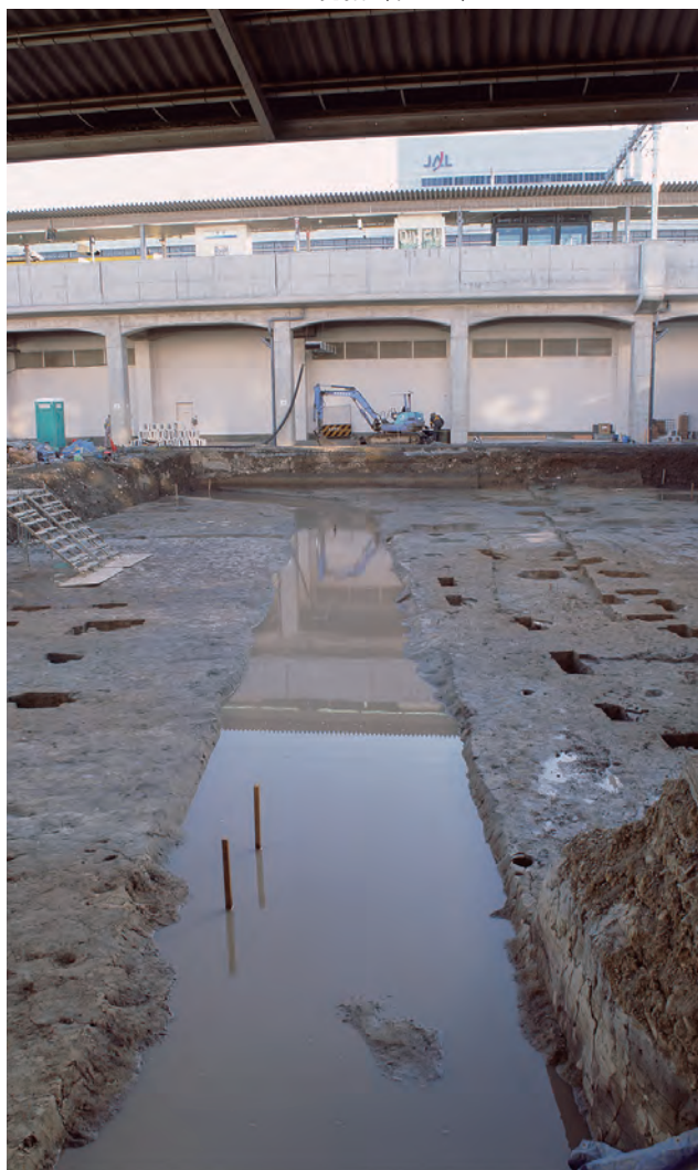
3. SD02滞水状況 (北から)
