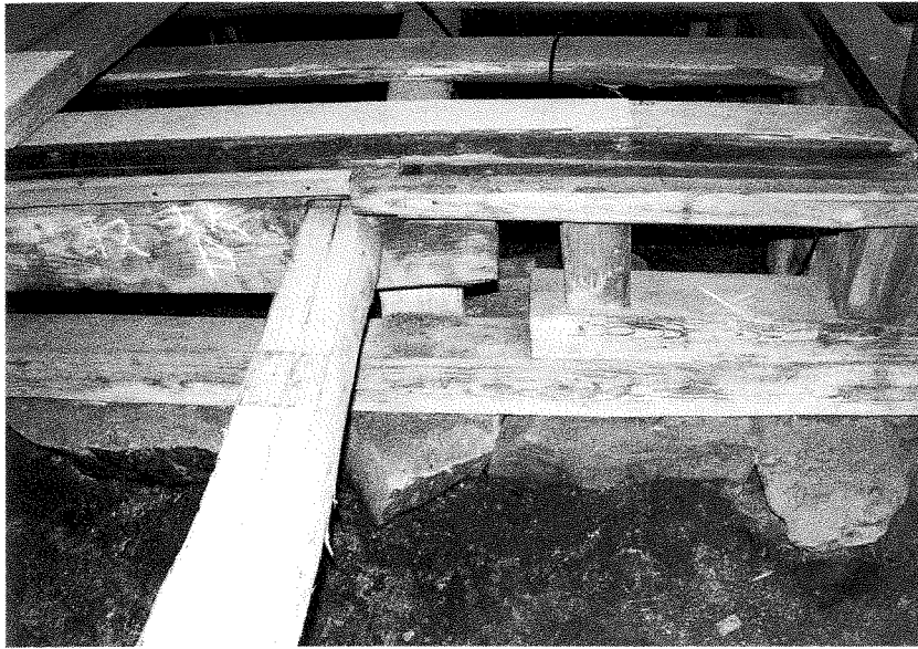
92 破損状況 柱脚部が腐朽したため二階に土台 が敷かれていた。 床組材の腐朽もひどかった
