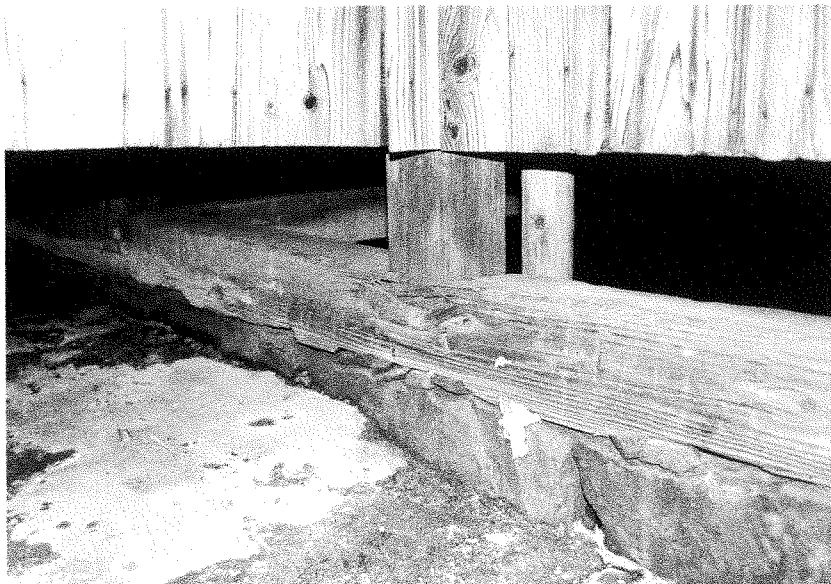
91 破損状況 土台に柱が減り込む
