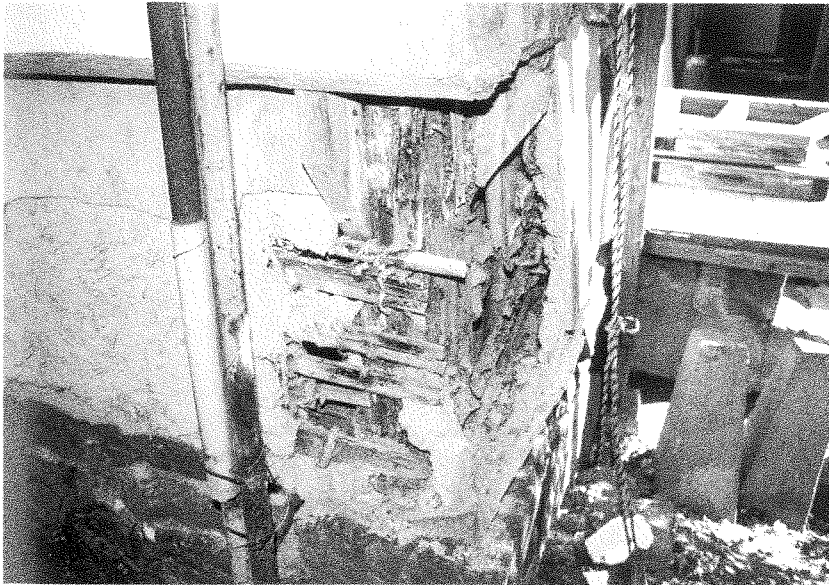
128 工事中 土蔵 外壁の破損状態 所々に亀裂や剥落が見られた
