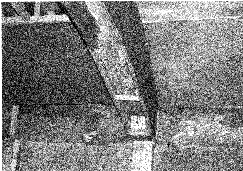
126 修理前 土蔵 内部 小屋梁 ベニヤ板のタイコ張りで覆われている
