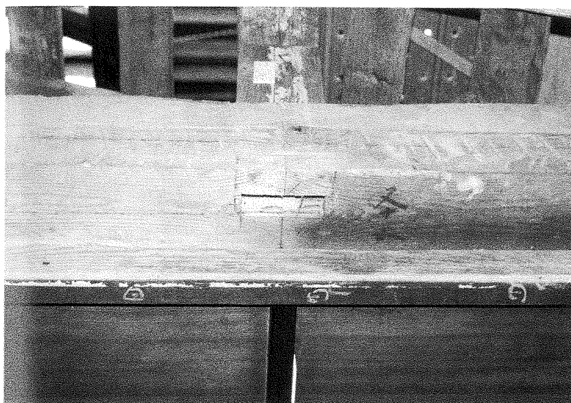
117 現状変更資料 (二)の(に)柱痕跡 桁に残る「又十五」半柱の痕跡
