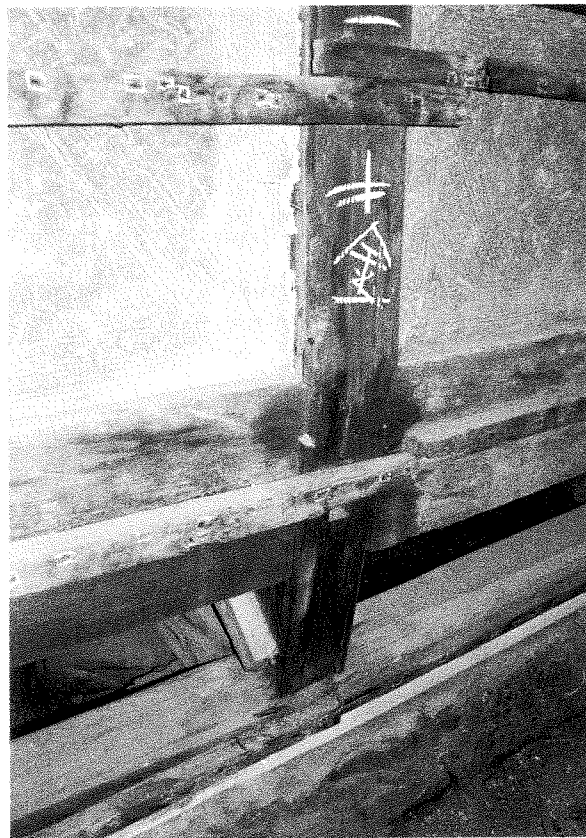
90 破損状況 柱脚部で折損していた(一)、(お)柱
