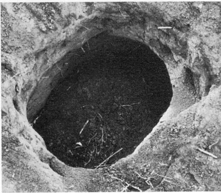
c. EI-55ピット (崩壊状況)
