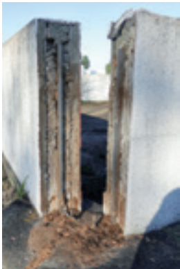
図65 建物の木柱下部の劣化により生じた木屑
