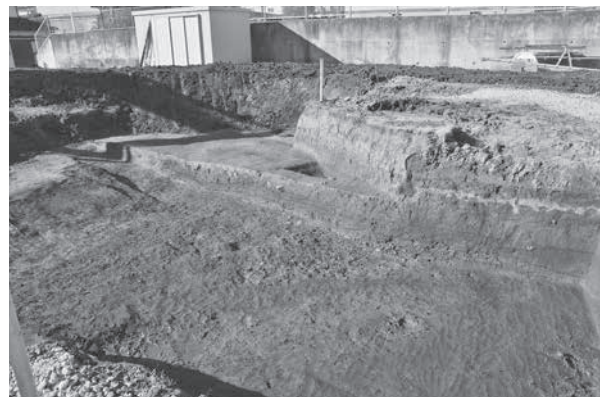
分譲地地点落ち込み断面 (東より)
