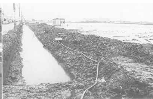
3トレンチ冠水状態（西から）
