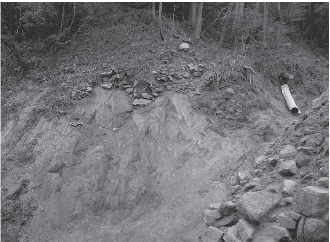
第 45 次調査 大石垣 西側面崩落状況（南東から）
