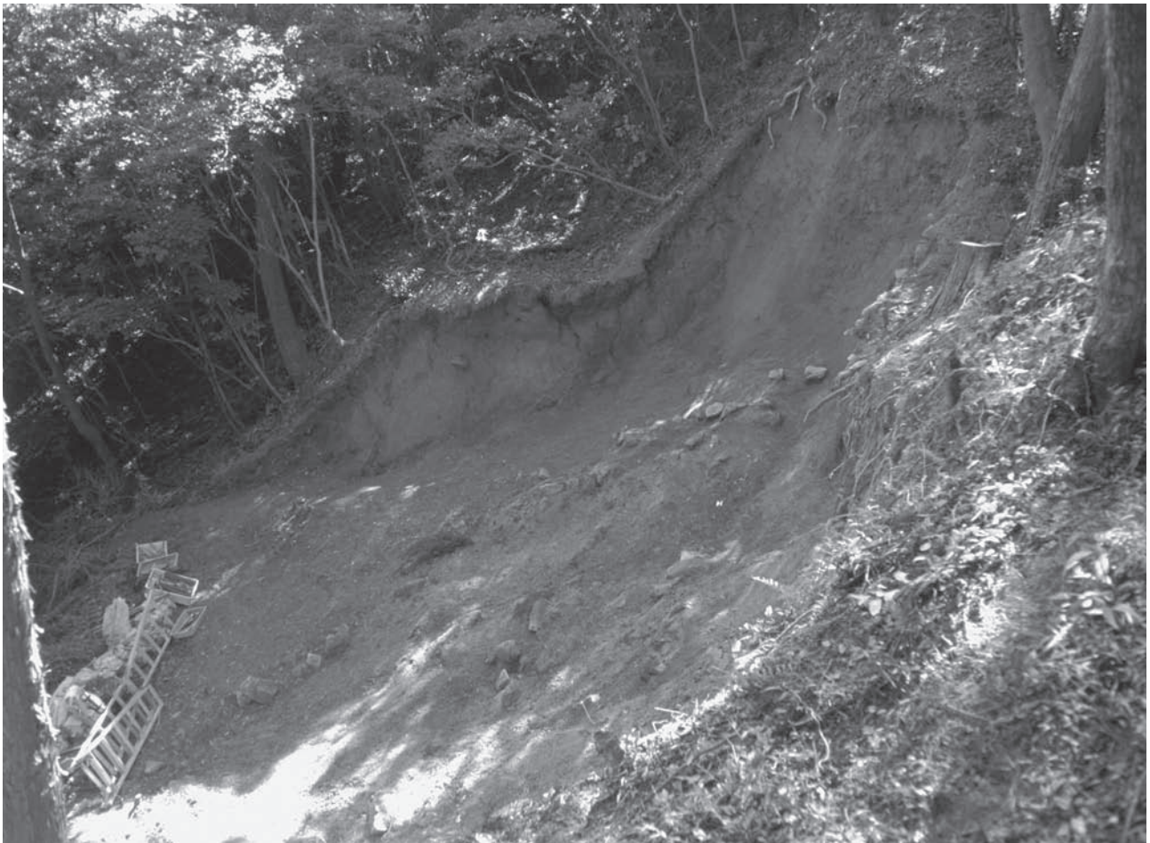
第 48 次調査 崩落部 調査前草刈後状況 調査区南側状況（北東から）
