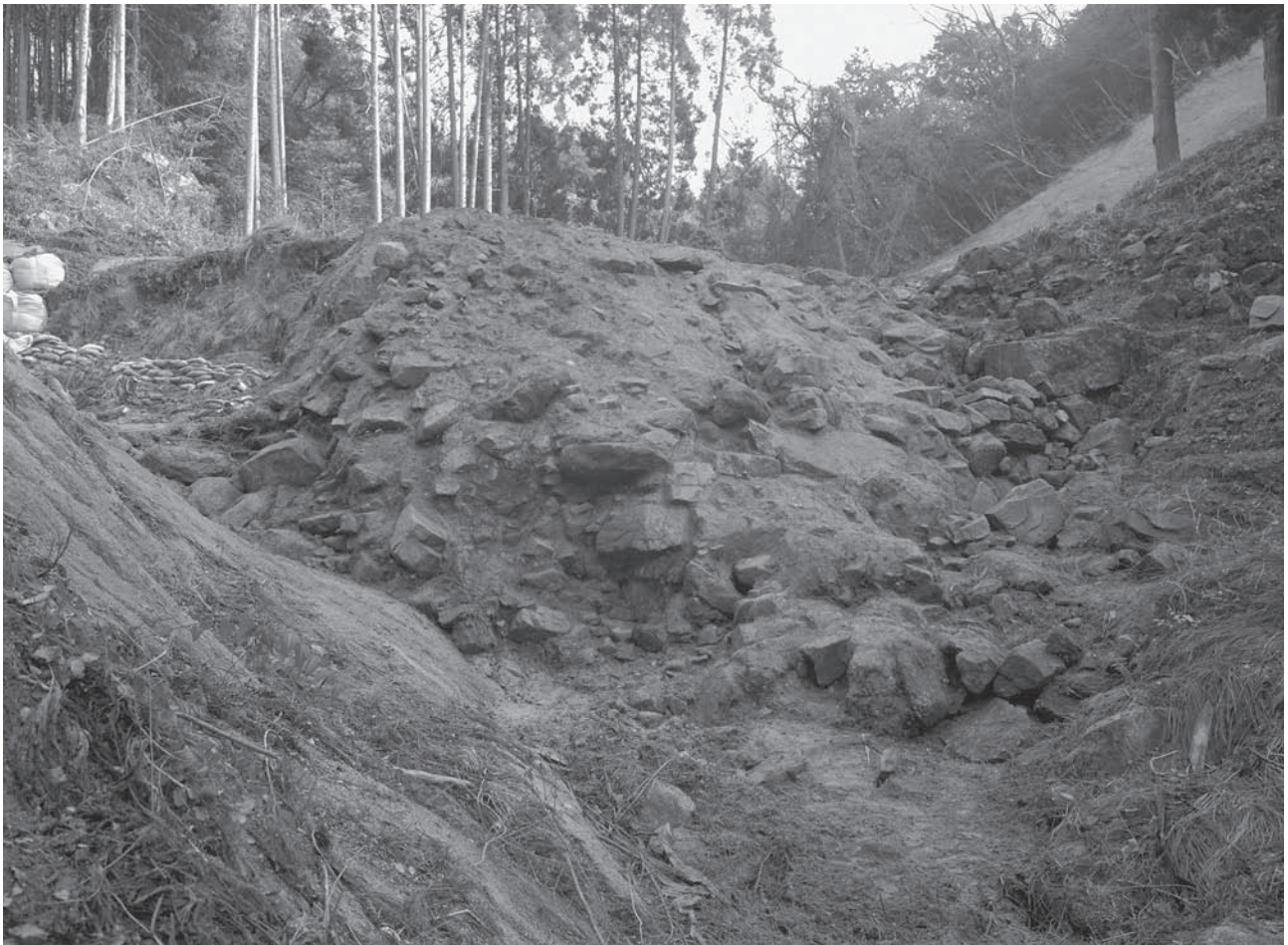
第 45 次調査 大石垣正面 積石崩落状況（南西から）
