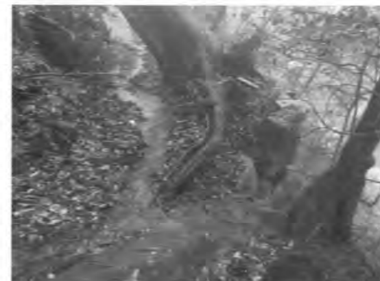
図5 坊跡石垣をえぐる雨水
