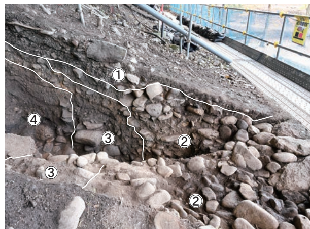
T 3 南壁土層断面（北から） 石垣修理に伴う裏込層を土層断面でも確認
