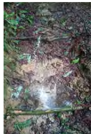
写真4-10 降雨後の散策路 (平成29年6月23日撮影)
