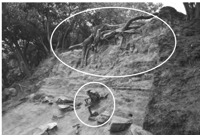
写真5-1 松の根による土塁の被害状況
