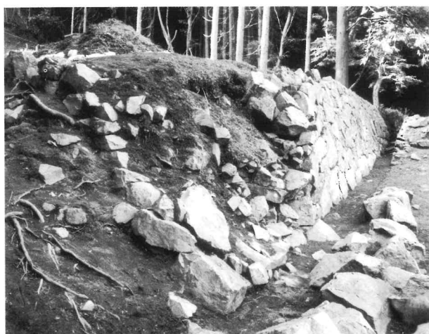
3号石垣南隅部（崩壊状況）
