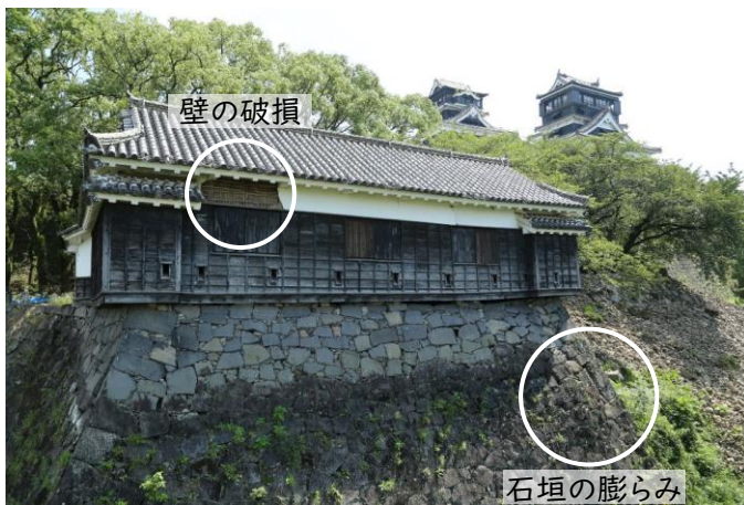
平櫓の被害状況（平成28年〔2016年〕4月）
