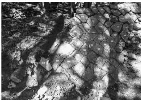
写真6 TT1 法敷石垣崩落状況 (東から)
