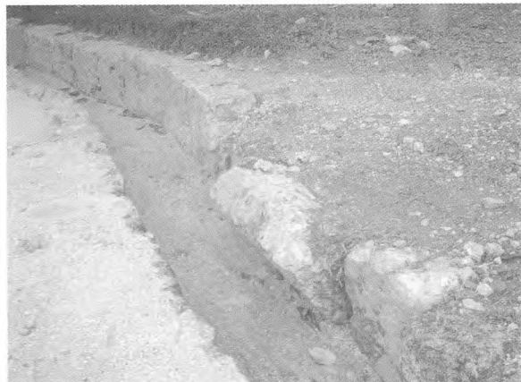
10. 石組排水溝（倒れ箇所）
