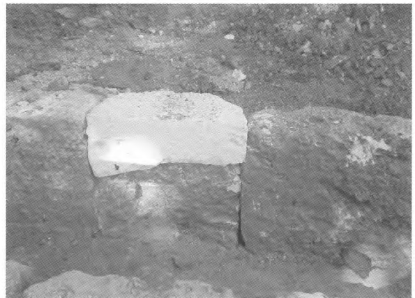
13. 排水溝設置 (破損箇所)
