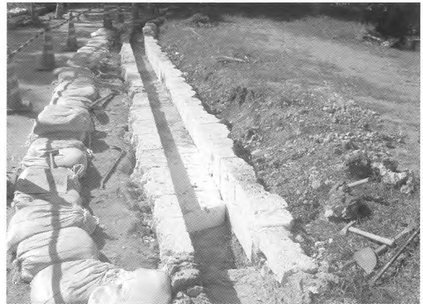
12. 排水溝設置 (欠損箇所)
