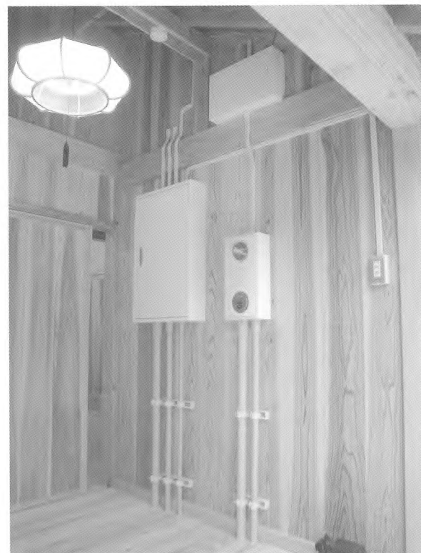
84. 左：電灯盤、中：総合盤、上：感知器収納箱
