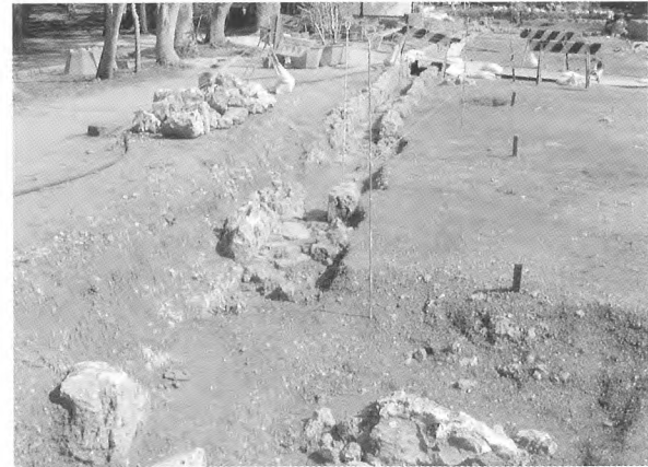
6. 石組排水溝（欠損箇所）
