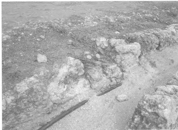
9. 石組排水溝（破損箇所）
