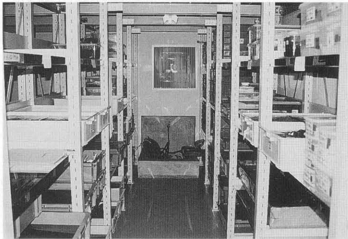
第32図 収蔵庫内の給排水設備
