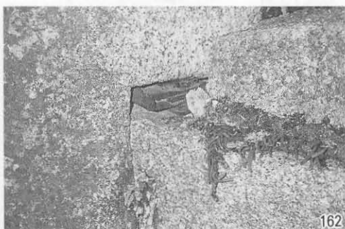
貫石鉄片状況
