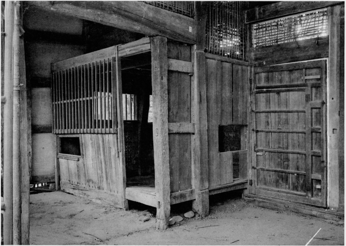
20 修理前 門番部屋間仕切
