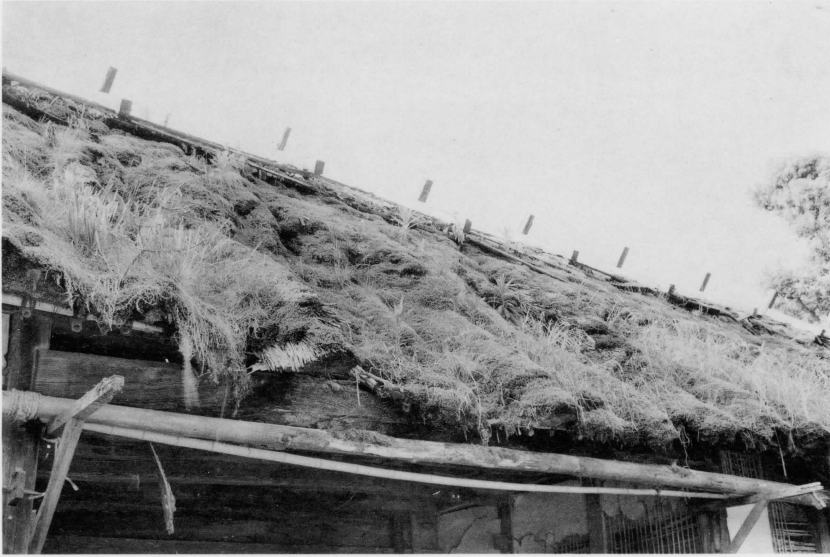
25 破損状況 背面屋根
