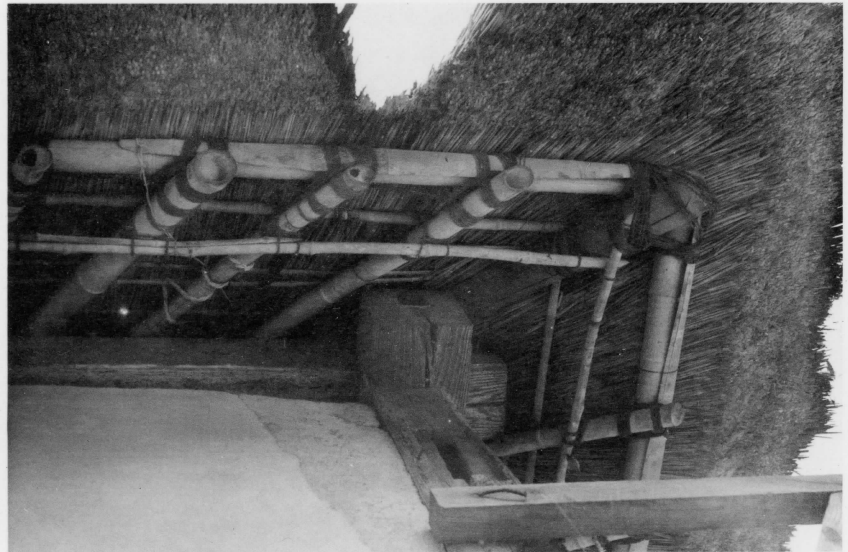
26 破損状況 東南隅の屋根
