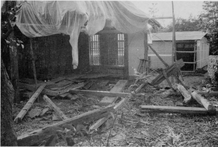
28 破損状況 男部屋(西端)
