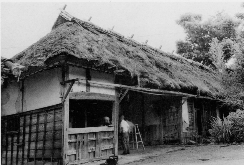
27 破損状況 背面屋根
