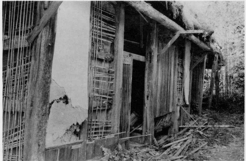
23 破損状況 背面通り
