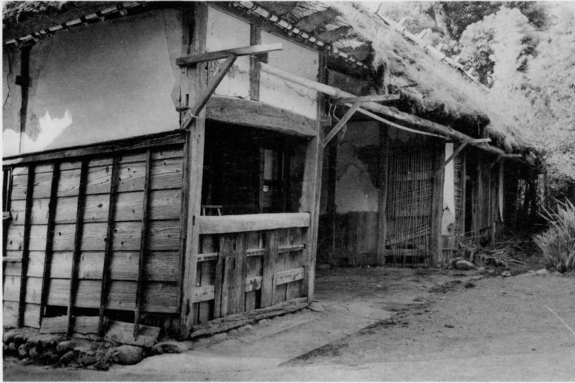
22 破損状況 背面通り
