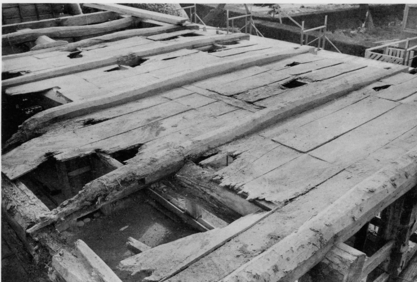
30 破損状況 長屋通り天井
