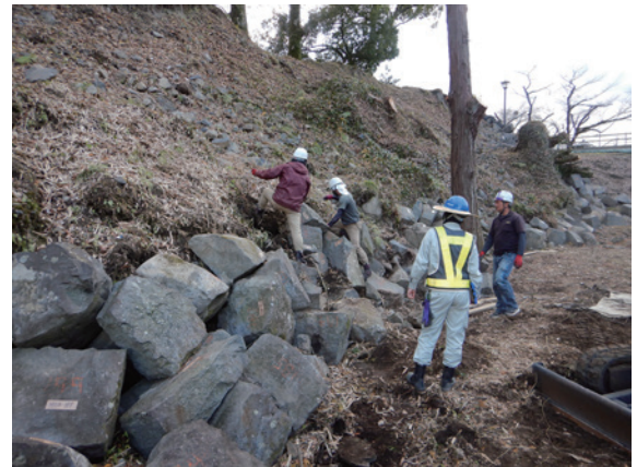
H118 石垣崩落状況
