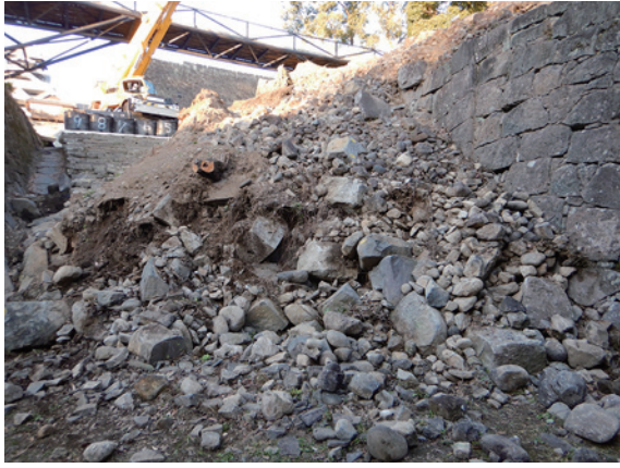
H209 石垣崩落状況
