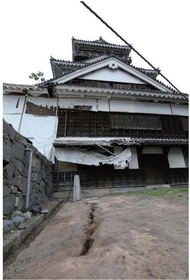
宇土櫓前地割れ状況 (南から)
