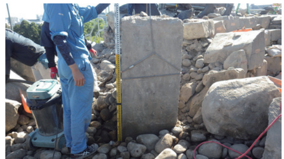
昭和 28 年設置のコンクリート基礎
