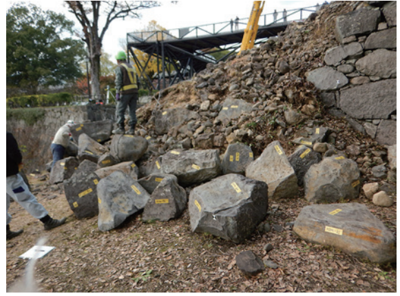
H204 石垣崩落状況
