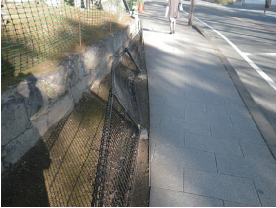
き損状況（南から）
