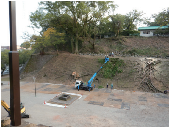
H118 石垣崩落状況
