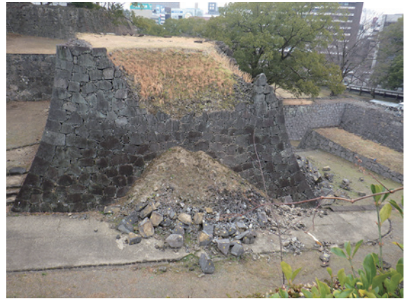
H233 石垣崩落状況
