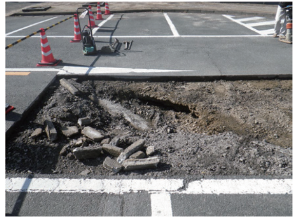
陥没状況確認 (東から)
