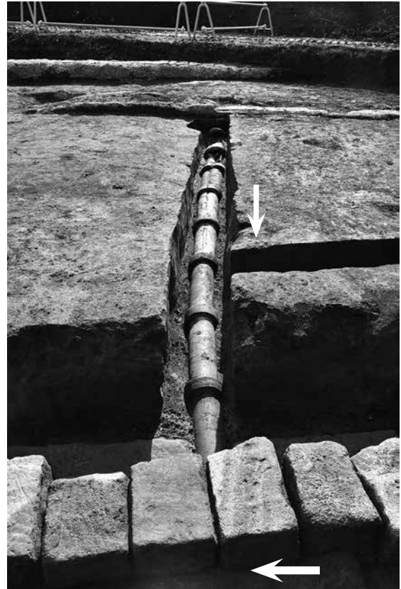
2 排水路枝管 (矢印:水流方向) (北)
