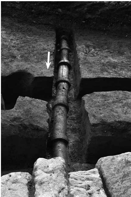
3 排水路枝管 (矢印:水流方向) (北)
