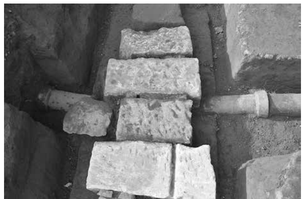
8 排水路 本管と枝管
