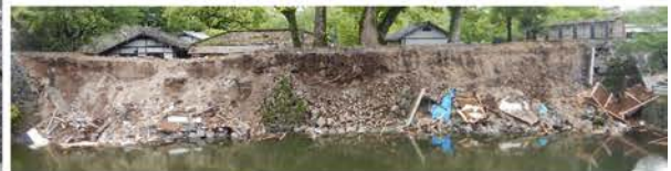
本震後崩落状況写真（西から）
