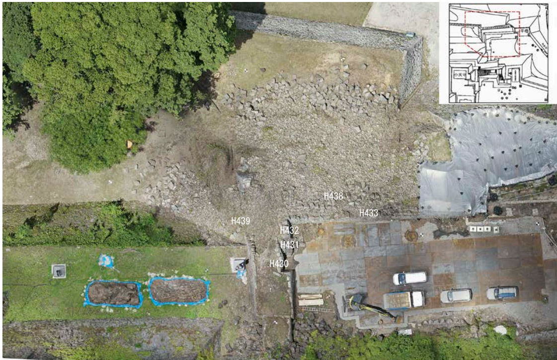
石門北側石垣崩落状況（上が北）
