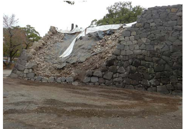
崩落石材回収完了状況（南から）
