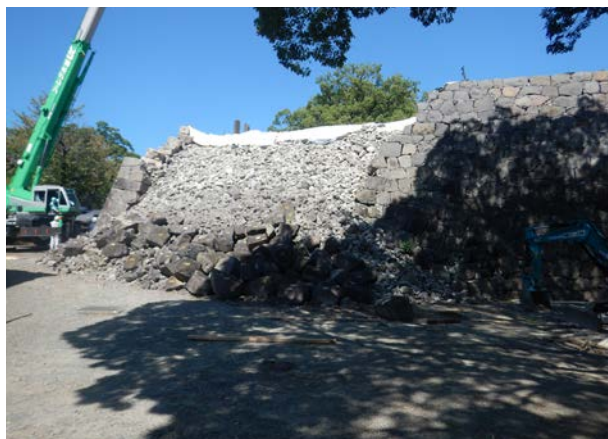
崩落石材回収前の状況（南から）
