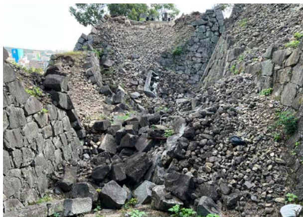
石門南側 崩落状況（西から）
