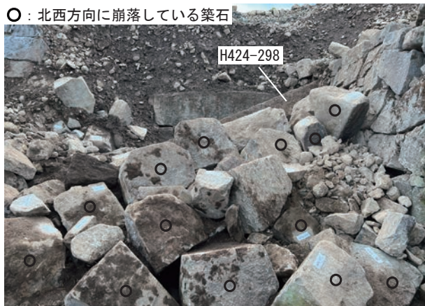
H424 3層目崩落状況（北から）
