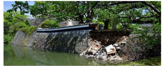
前震後崩落状況写真（南西から）
