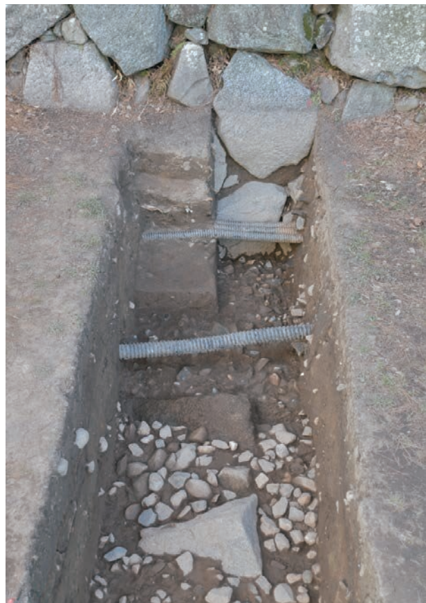
2 W区東西トレンチ石列・石垣面地中部分検出状況（東から）
