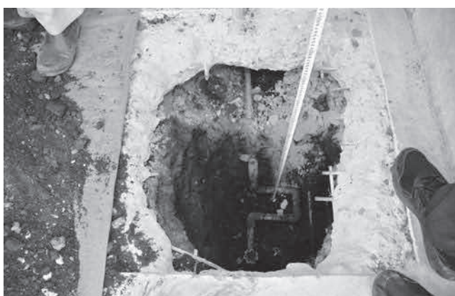
写真49 漏水管発見状況(北より)
