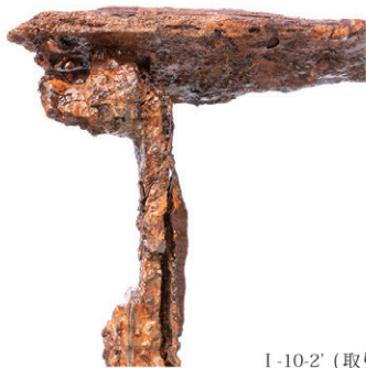
I-10-2' (取り付け部拡大写真)
