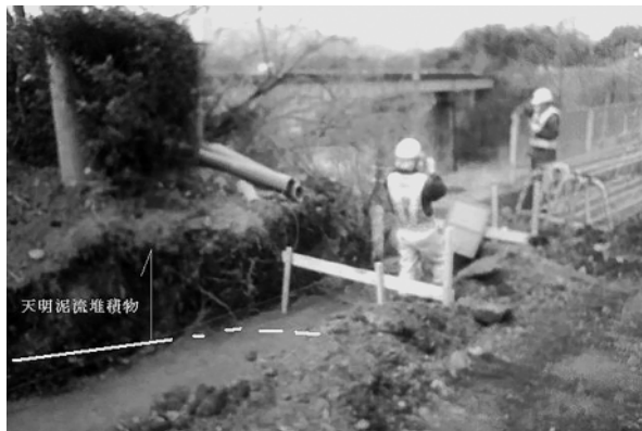
写真23 松見橋左岸側工事 1m程度の天明泥流堆積物が確認できた(2009年3月)。
