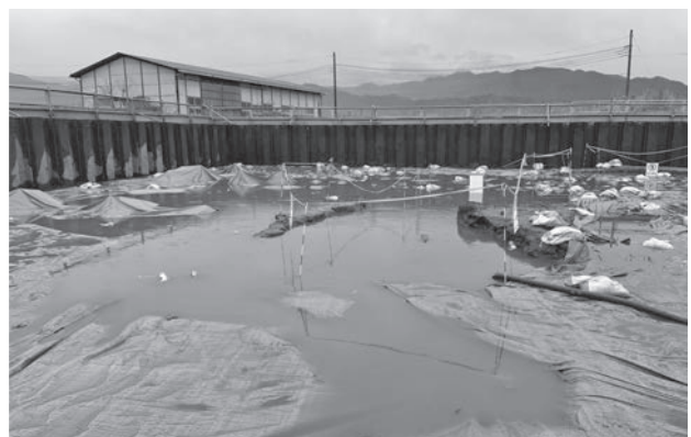
○現場が水没している様子（第5次）
