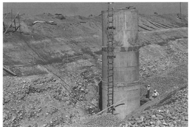
写真12 三和工業団地I遺跡の北に隣接する書上 上水場建設当時の写真（昭和46年）
