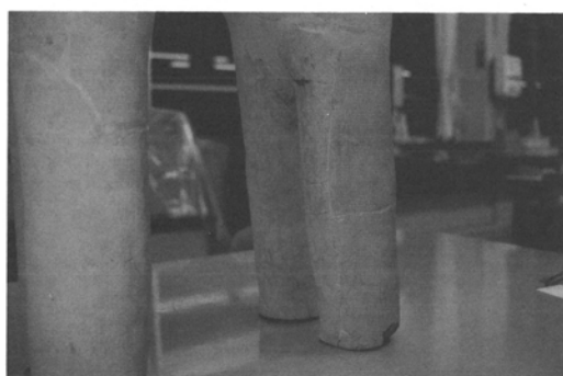
5. 左前脚縦方向の亀裂
