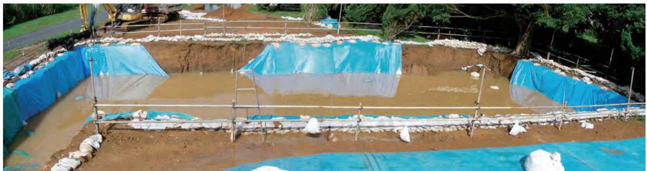
2トレ冠水状況 (9/18)
