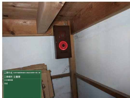
21 火災報知器設置完了状況（文書庫）
