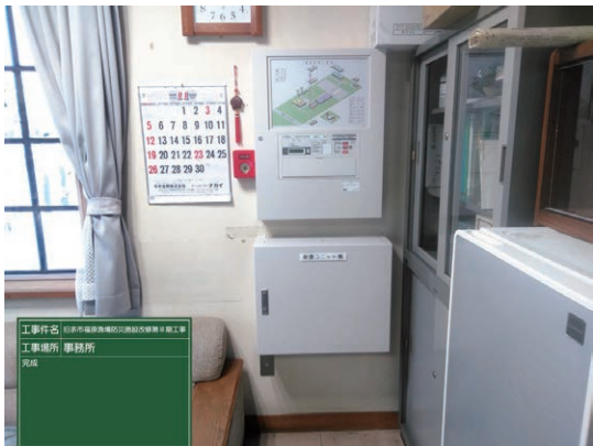
32 受信盤設置完了状況（事務所）
