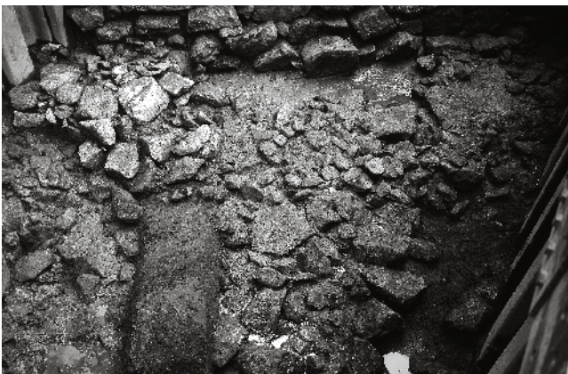
(4) 土橋南面石垣崩落状況 (南から)
