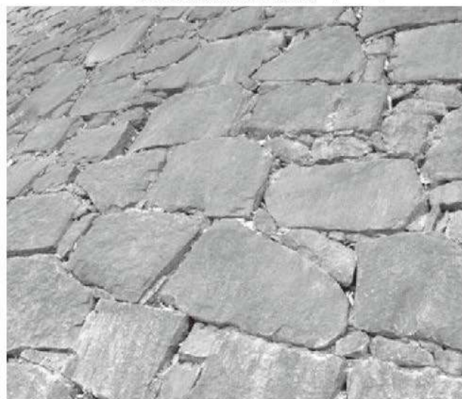
⑥ 同南面築石 (割石、面の整った野面石で平滑な面を構成する)
