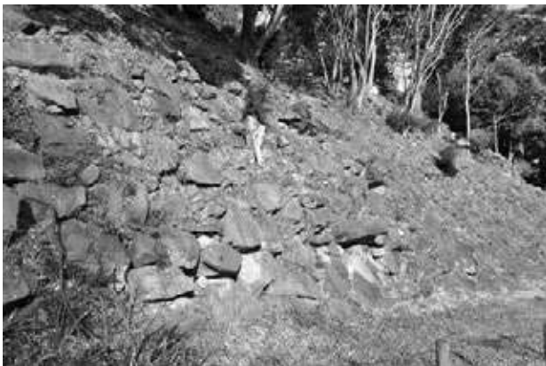
写真13 石垣山城 南曲輪崩れた南側築石部
