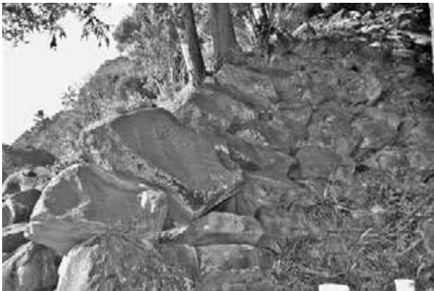
写真11 石垣山城 南曲輪崩れた隅角部
