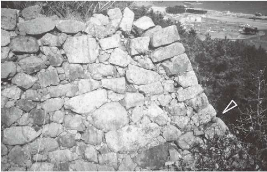
① 山上部 隅角部 (稜線に変化点がみられる)
