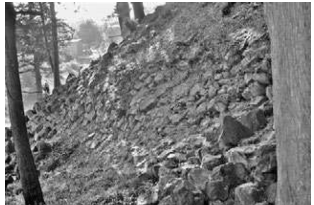
写真12 石垣山城 南曲輪崩れた東側築石部
